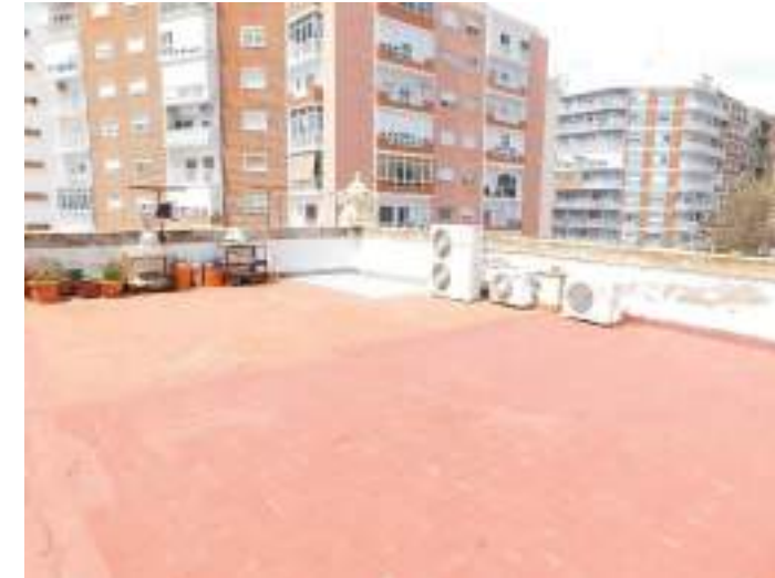
Humedades y vegetación en los elementos de cubierta.
