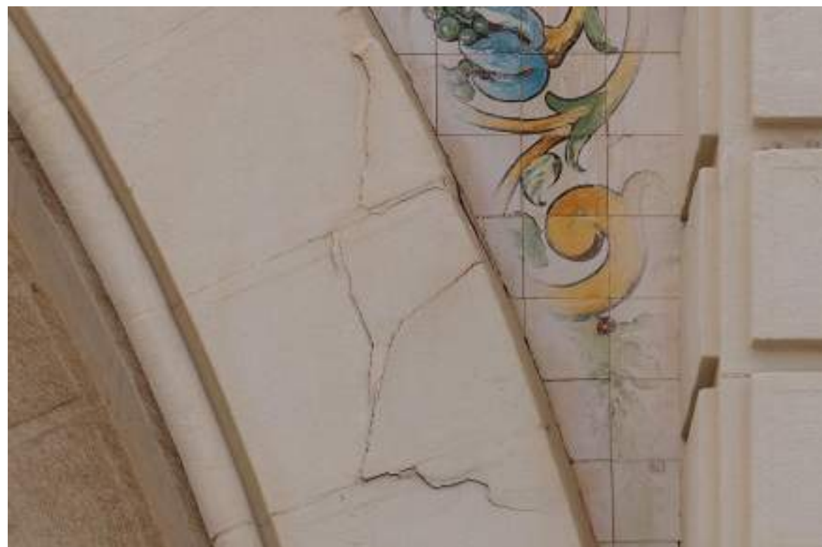
Detalle de las fisuración del arco central de la fachada principal realizado con piedra caliza. Aquí se diferencian las fisuras de apertura muy pequeña en las juntas entre sillares y otras de mayor envergadura que están causadas por tensiones producidas en el material pétreo subyacente.
