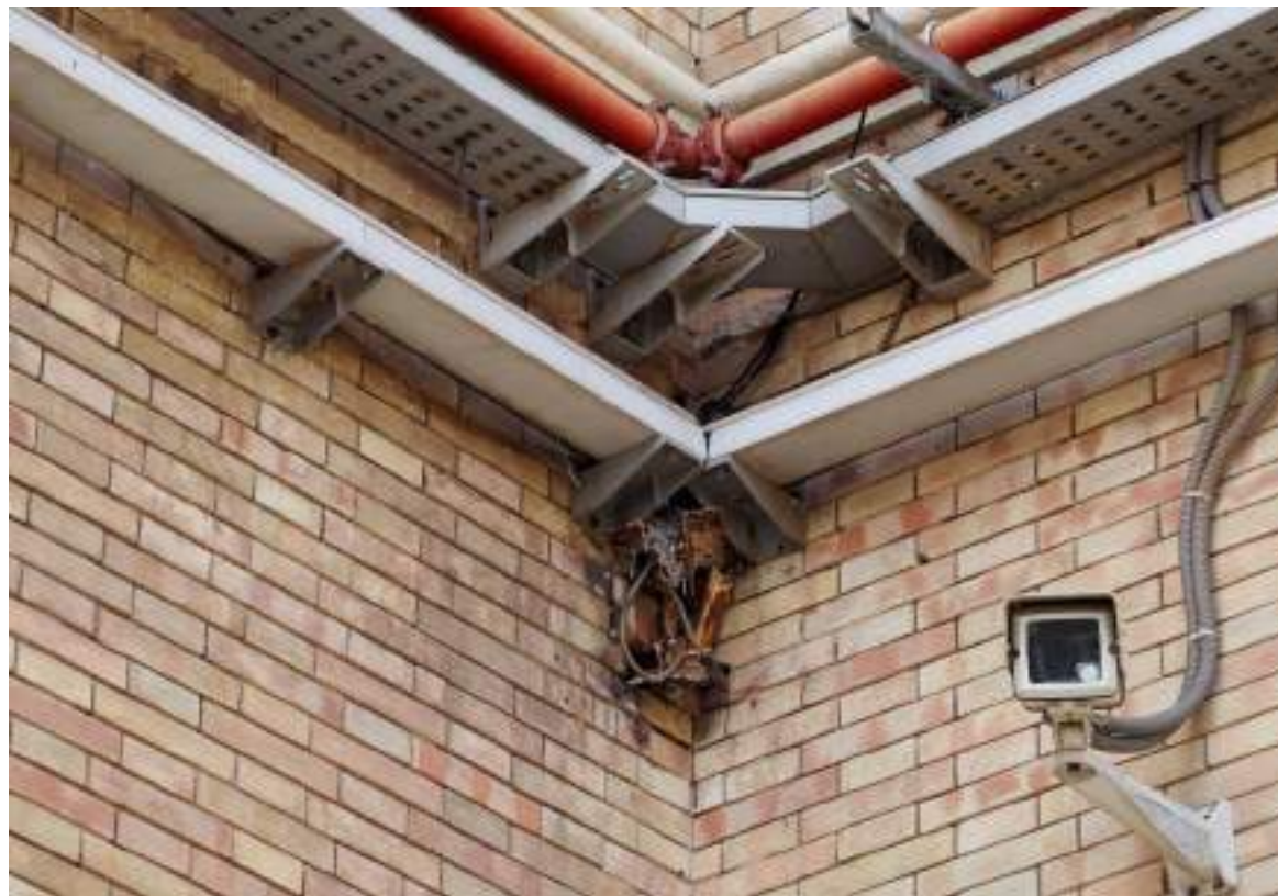
Distintos elementos auxiliares para la sujeción cables y vigilancia en las fachadas interiores del edificio de viajeros, donde también se pueden ver también los restos de la antigua marquesina que cubría la zona de andenes.
