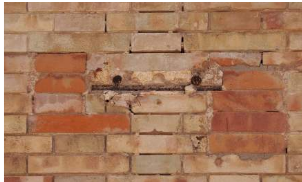
Detalle de una zona donde debió haber instalado algún elemento que a día de hoy no se conserva. Al retirarlo se dejaron los elementos metálicos de sujeción y se retacaron los huecos con piezas de ladrillo.
