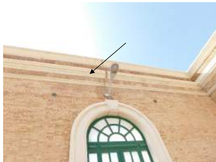
Grieta vertical sobre hueco de muro norte. Hueco junto a la estación.
