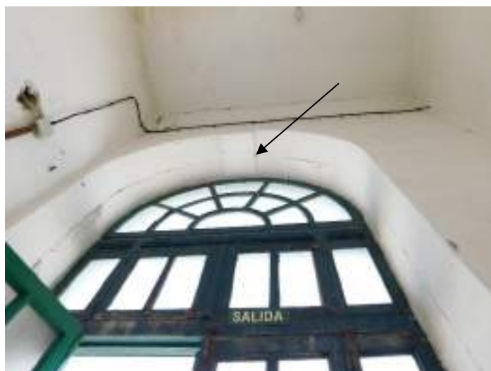
Fisura continua en la embocadura de la puerta. Ampliación de la nave sur.
