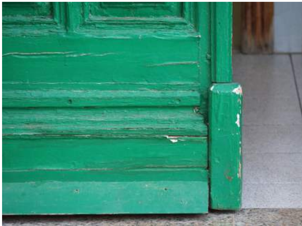
Detalle del aspecto de una de las carpinterías donde se aprecian numerosas fisuras producido por el estrés de la madera por tensiones internas del material
