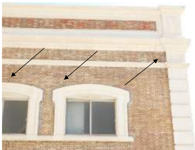
Grietas sobre los huecos y junto a la pilastra de fachada oeste. Vista en detalle
