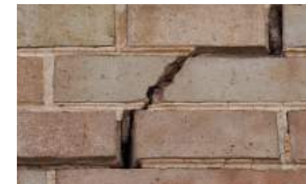
▼ Detalle de una grieta que parte una de las piezas de ladrillo que atraviesa.
