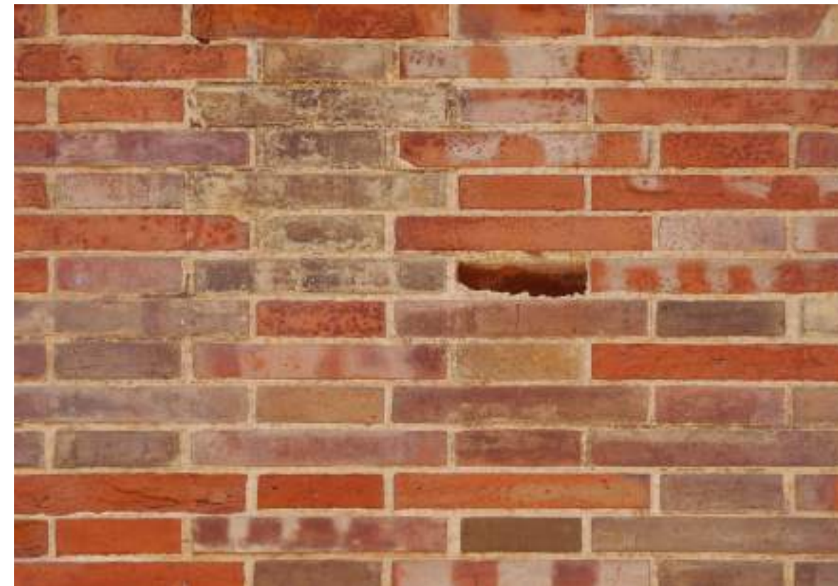
Detalle de una zona del muro de fábrica donde se aprecian las diferencias entre las piezas de ladrillo prensado originales y las más modernas.
