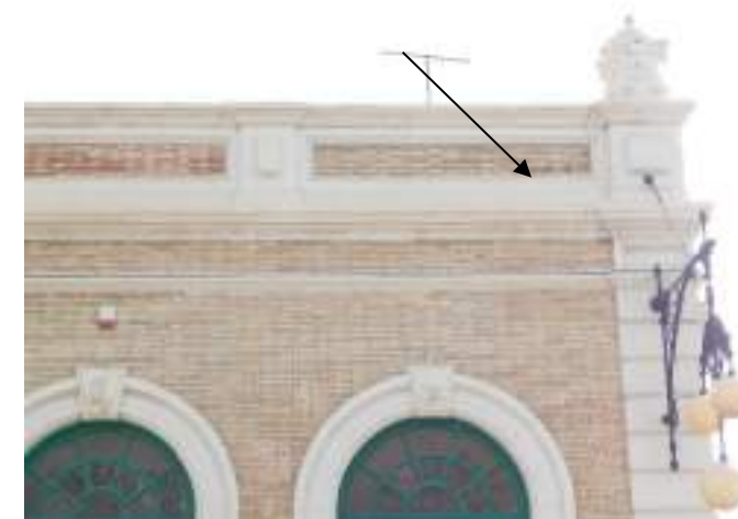
Grieta en fachada oeste de la nave lateral sur. Esquina sur.
