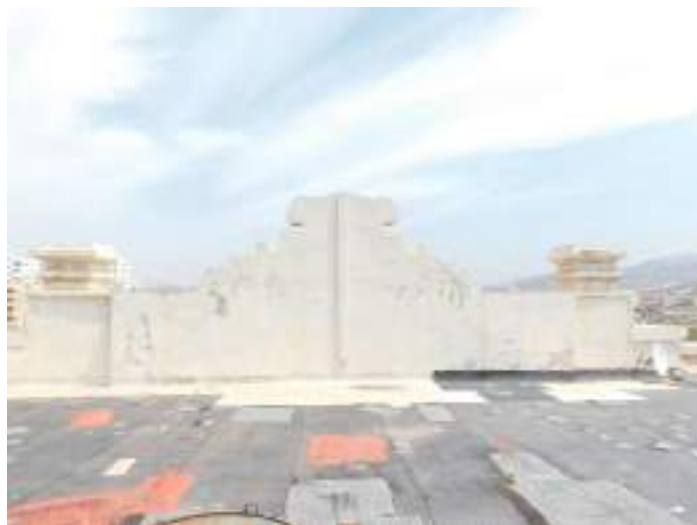
Parcheados en la impermeabilización de la cubierta de la nave central y levantamientos de pintura en petos y remates.
