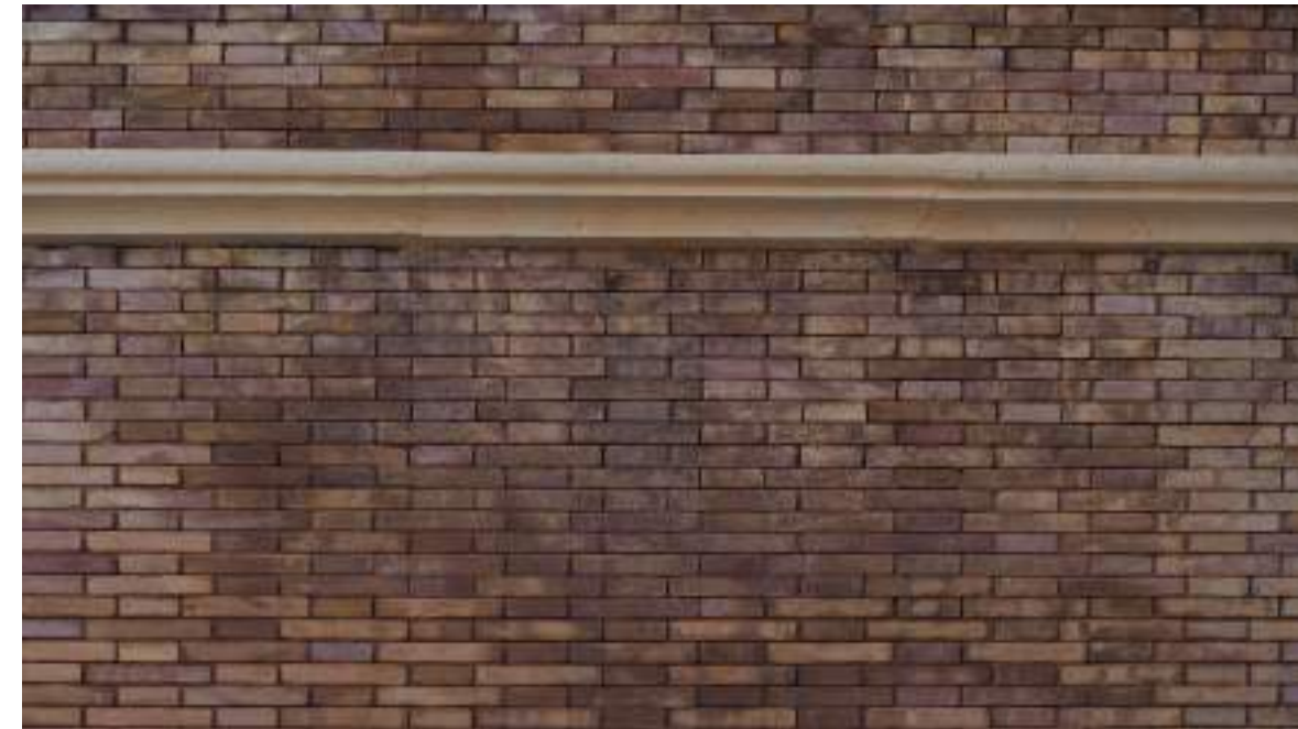
Imagen del muro de fábrica con un importante ennegrecimiento ocasionado por la filtración de agua y la acumulación de humedad.
