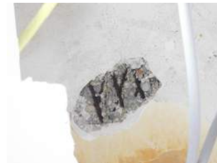
Desconchamiento del recubrimiento en la cara inferior de la losa. Vista inferior
