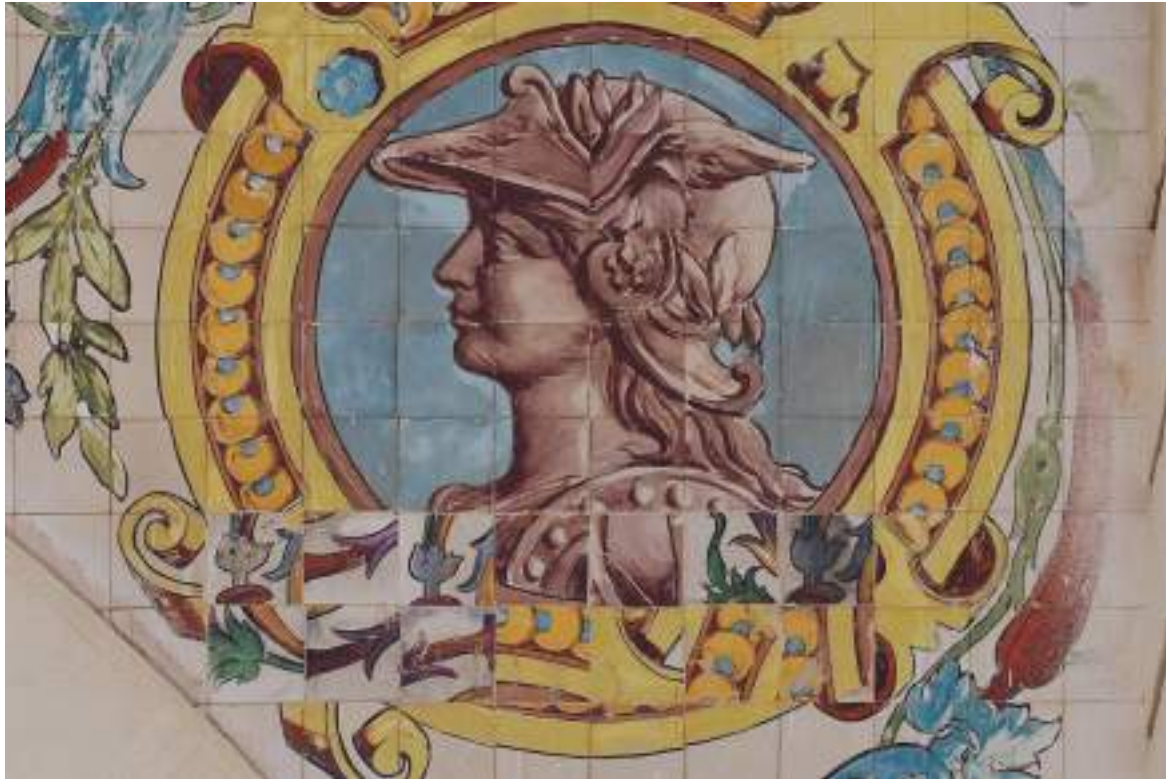
Aspecto actual del medallón derecho de la decoración de azulejos, donde se ven varias piezas mal colocadas o traídas de otras zonas del edificio.
