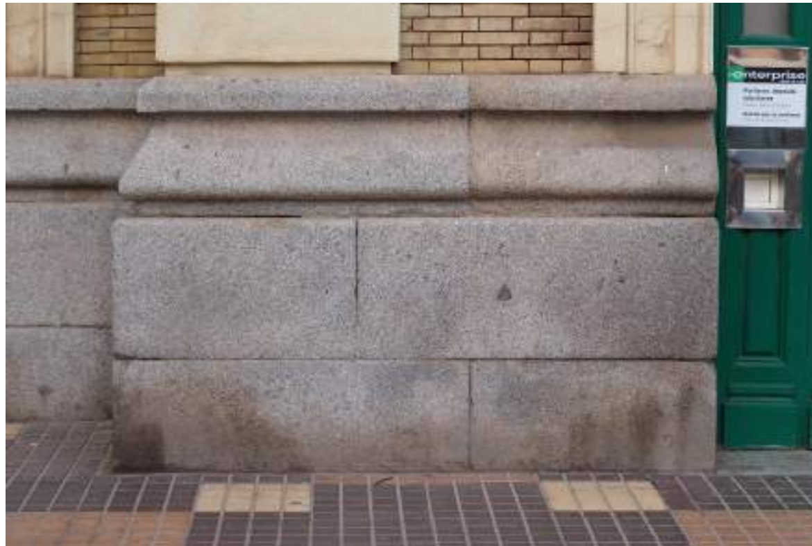
Imagen del zócalo de granito en la fachada principal del edificio principal de viajeros donde se pueden ver distintas alteraciones del granito.
