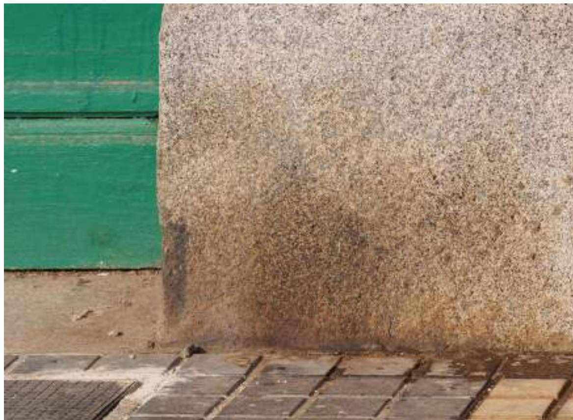
Acumulación de manchas de distinta naturaleza en la zona de inferior del zócalo de granito del edificio.
