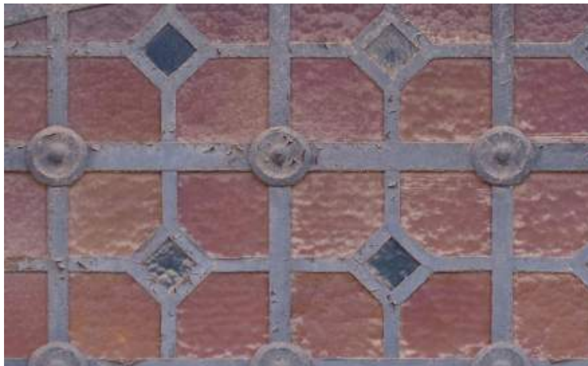
Detalle de la vidriera por el exterior donde se ven los depósitos de suciedad superficial además del levantamiento de la pintura de los elementos metálicos de la estructura, donde deja a la vista la corrosión del metal.
