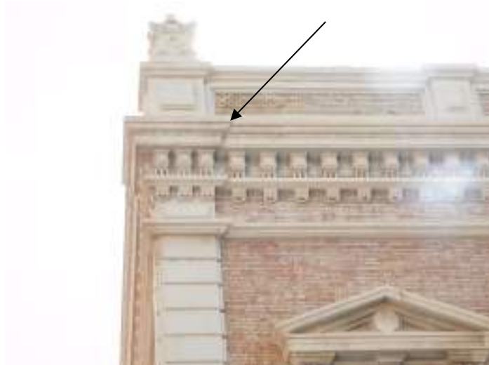
Grieta vertical en esquina del muro oeste. Nave central de acceso. Vista cercana.
