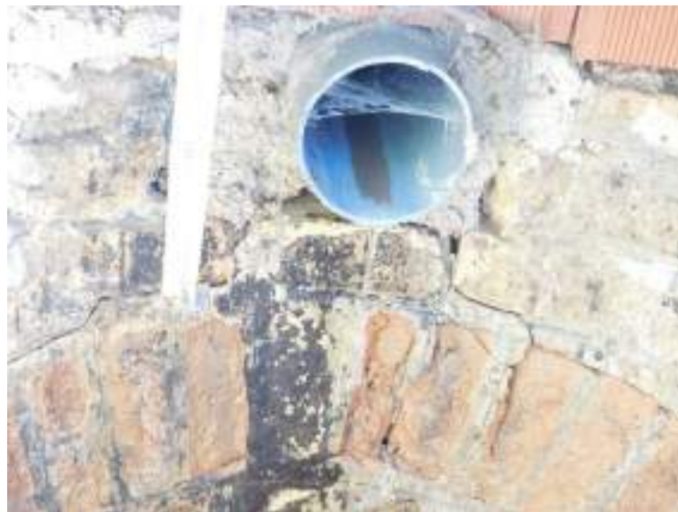
Tubo con vertido de agua en arqueta de galería.
