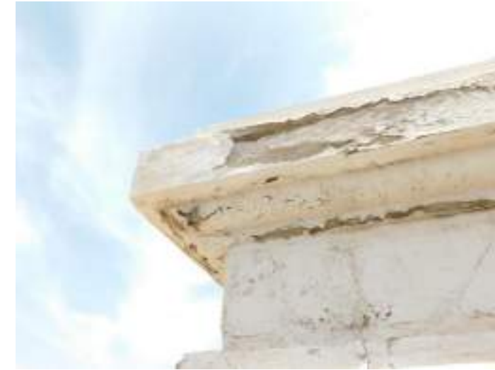
Levantamiento de pintura, desconchamientos y fisuras en acabados de elementos de remate de la cubierta.
