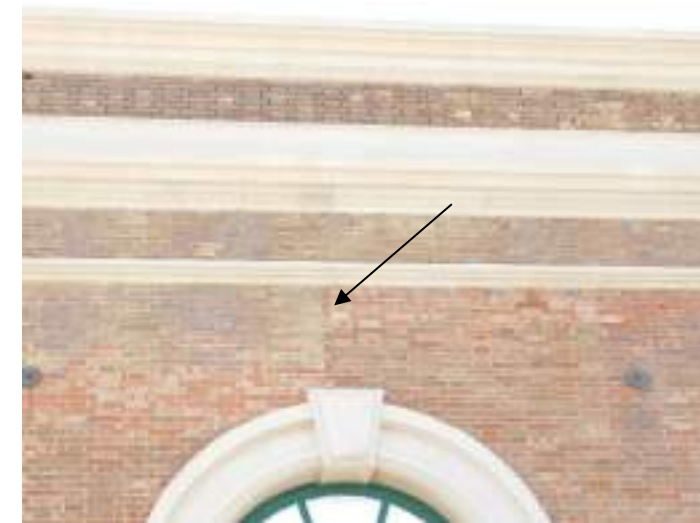
Grieta vertical sobre hueco de muro norte. Hueco más alejado de la estación.
