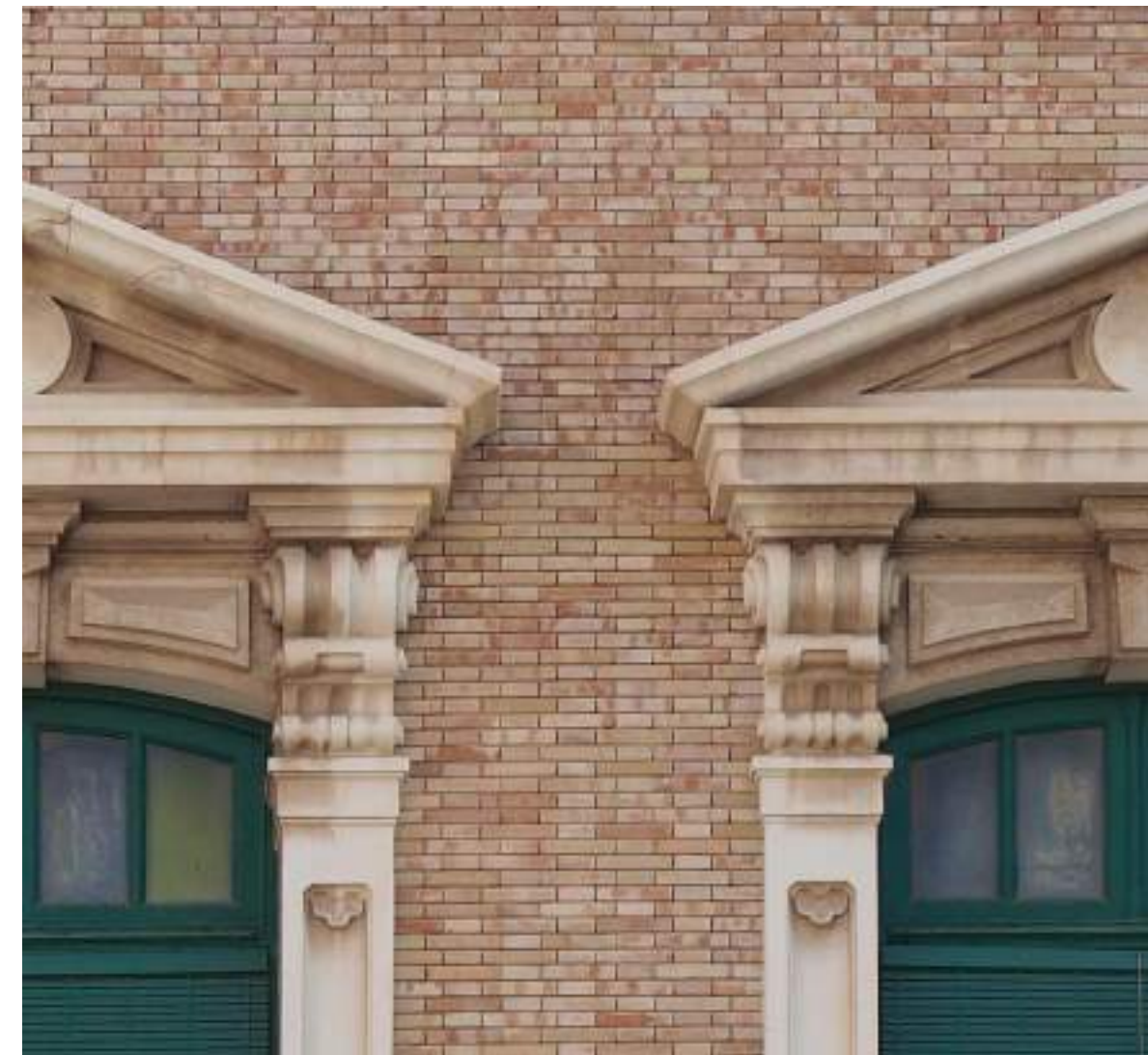
Detalle de la fachada principal en la que se identifican distintas alteraciones que tienen origen, entre otros, en los factores medioambientales.
