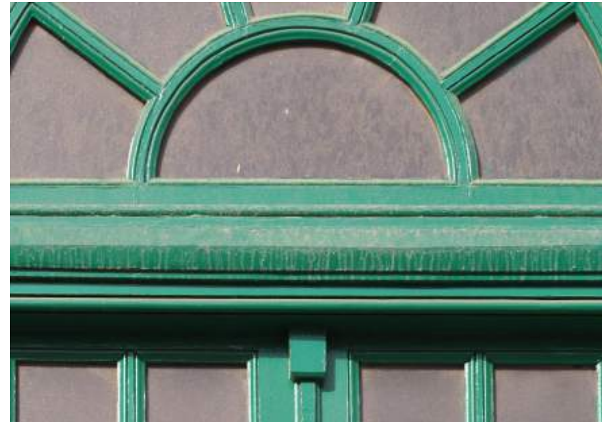
Depósitos de suciedad superficial y marcas de escurrimiento sobre la carpintería.
