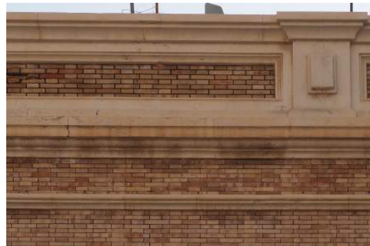
▼ Acumulación de suciedad superficial bajo la línea de imposta realizada en piedra caliza, donde el agua de lluvia no ha podido lavar la superficie.
