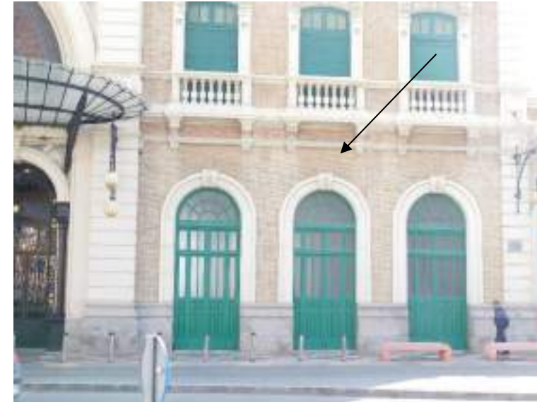
Grieta vertical en muro oeste. Nave central de acceso. Vista general.
