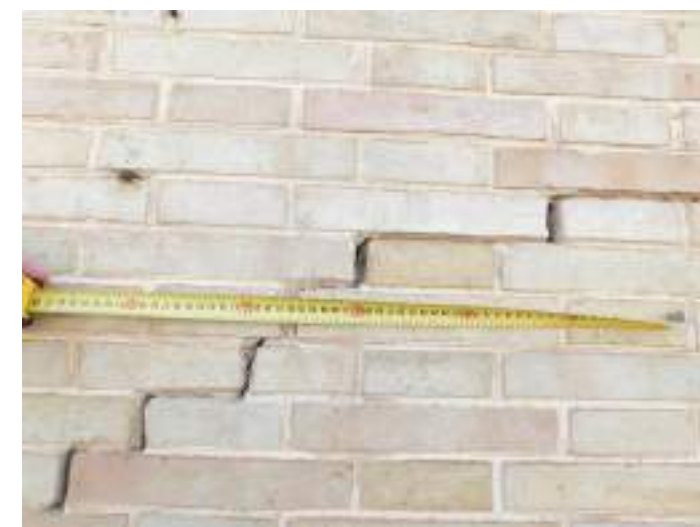
Grieta horizontal en muro sur. Apertura de grieta.
