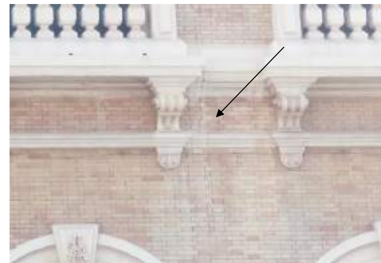
Grieta vertical en muro oeste. Nave central de acceso. Vista cercana.
