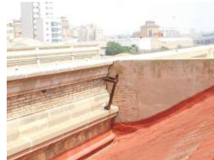
Grieta en el encuentro del muro testero de la ampliación con el muro de fachada norte.
