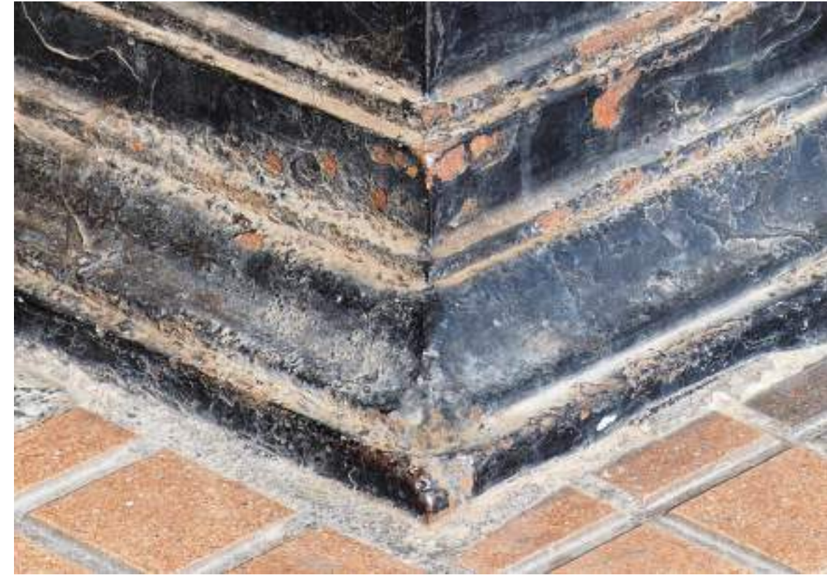
Detalle de la corrosión presente en las zonas inferiores de la pilastra.
