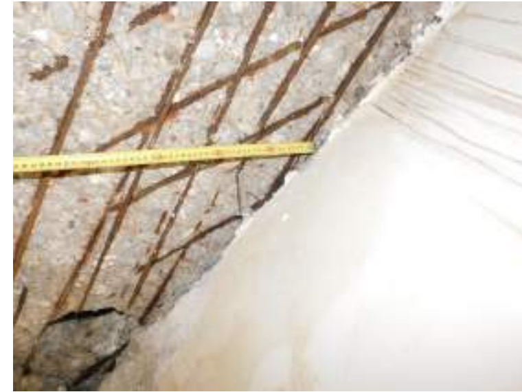
Desconchón en cubierta sureste.
