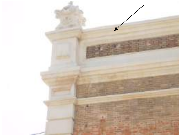
Grieta vertical en muro norte. Junto al extremo este.
