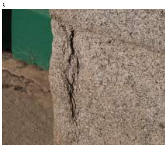
▼ Meteorización del granito, con la consiguiente pérdida volumétrica debido a la merma de resistencia mecánica que provoca el desmoronamiento del material.
