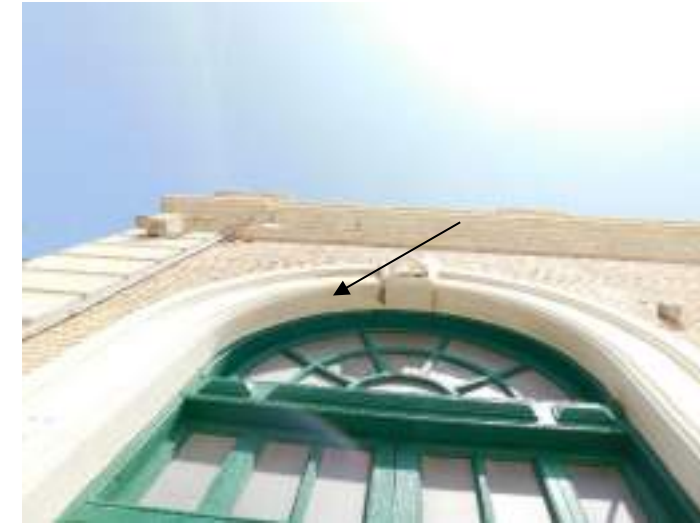
Grieta en la esquina oeste de la fachada sur. Vista en detalle.
