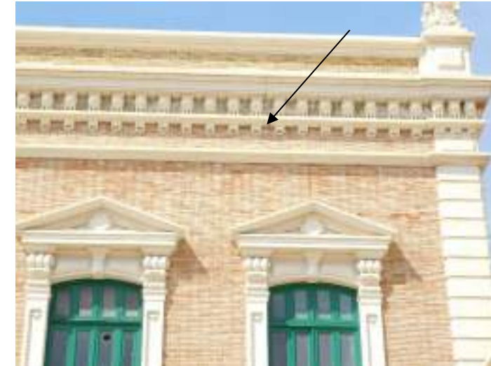
Grieta en esquina superior de la fachada este. Nave central. Vista general.
