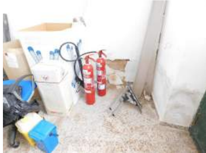
Humedades y desprendimiento del muro.
