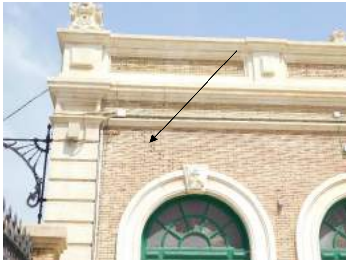
Grieta en la esquina oeste de la fachada sur. Vista general.
