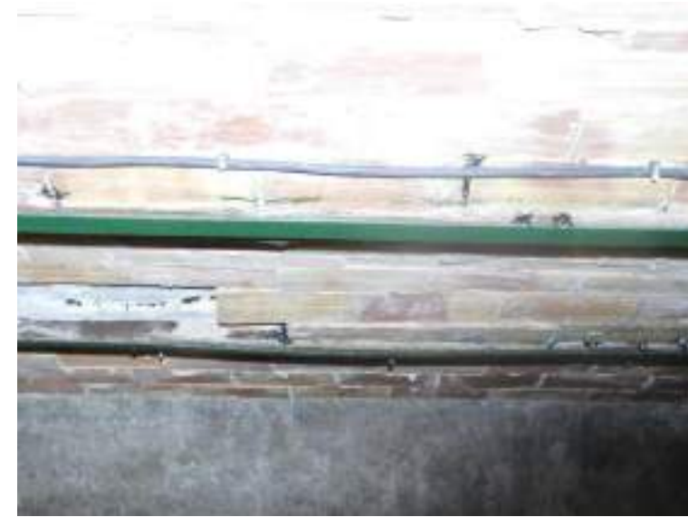
Deformación de vigueta en forjado de cubierta principal.
