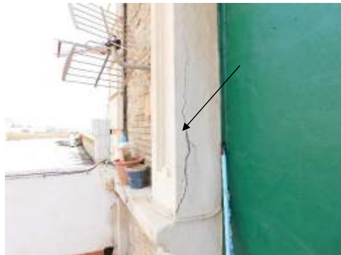
Grieta vertical en embocadura de puerta de fachada norte. Nave norte. Vista en detalle.
