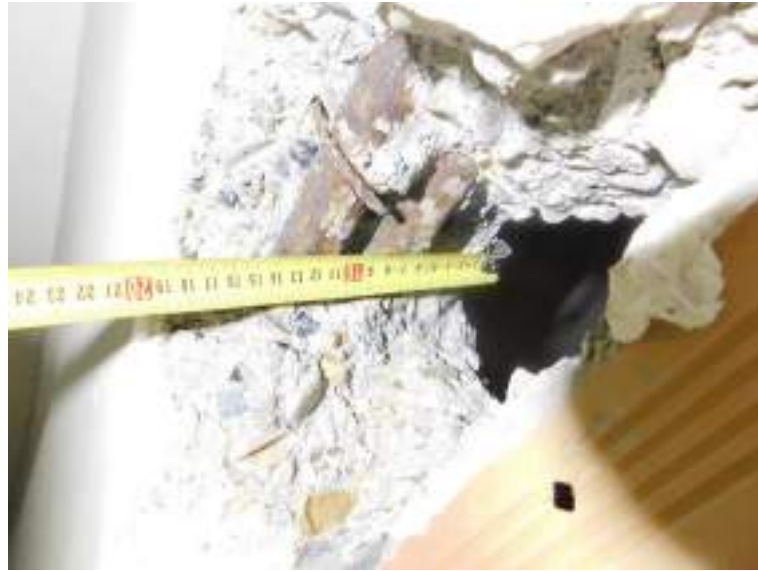
Detalle de cata en centro de vano de viga de cubierta en cuerpo sur.
