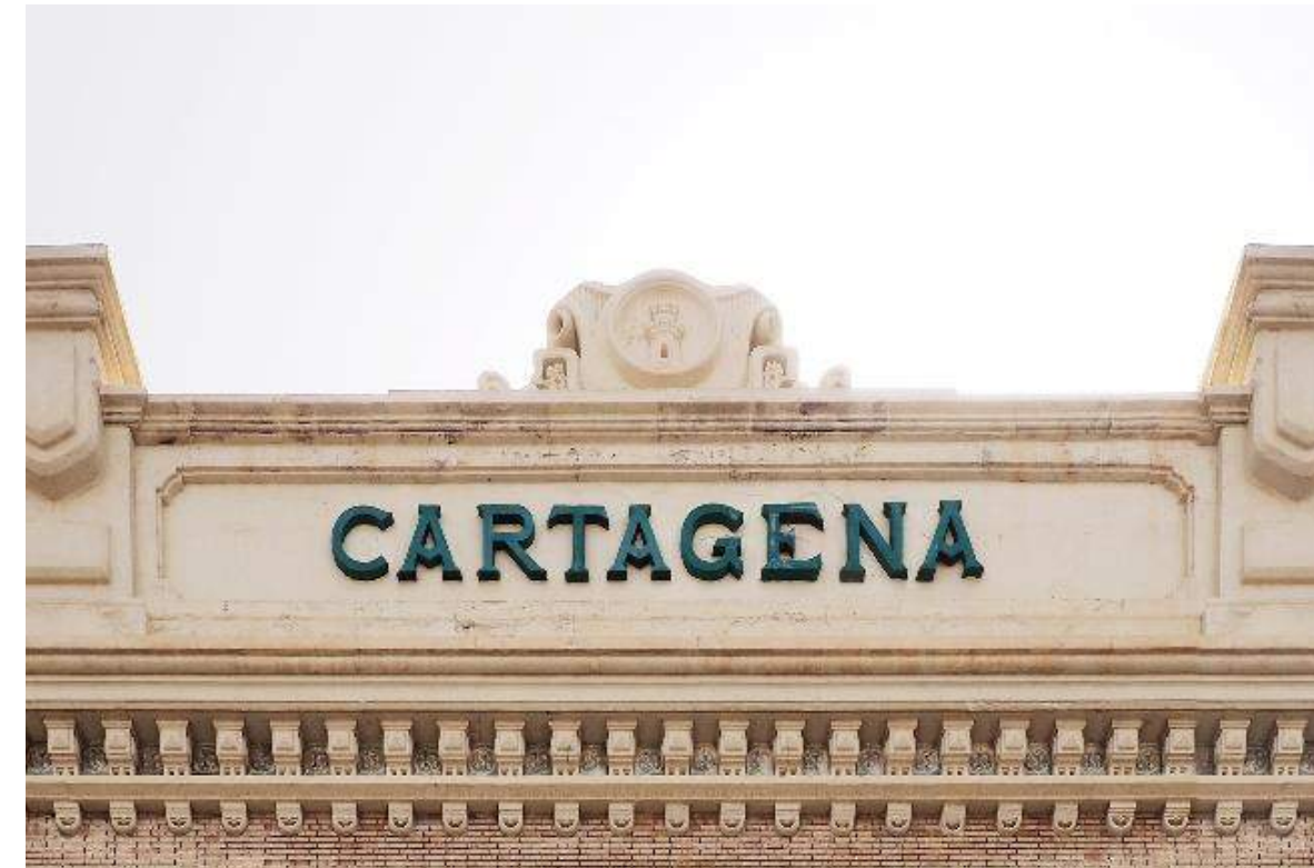
Cartela en el remate de la fachada principal hacia la zona de las vías. Todos los elementos decorativos está realizados con piedra artificial.
