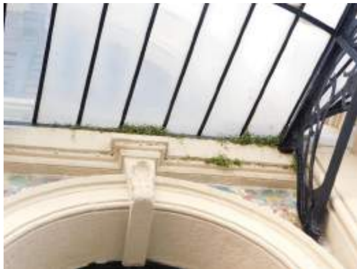
Humedad y vegetación en el encuentro de la marquesina con la fachada.
