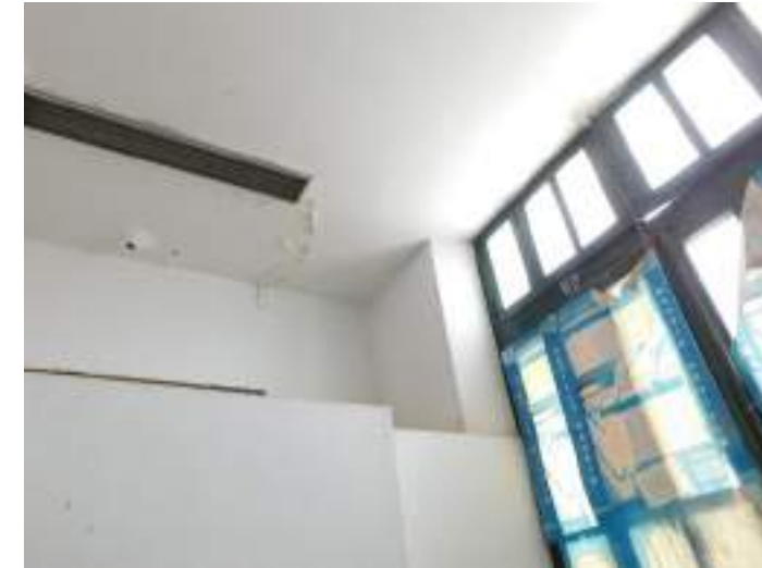
Levantamiento de pintura y fisuras en falso techo.
