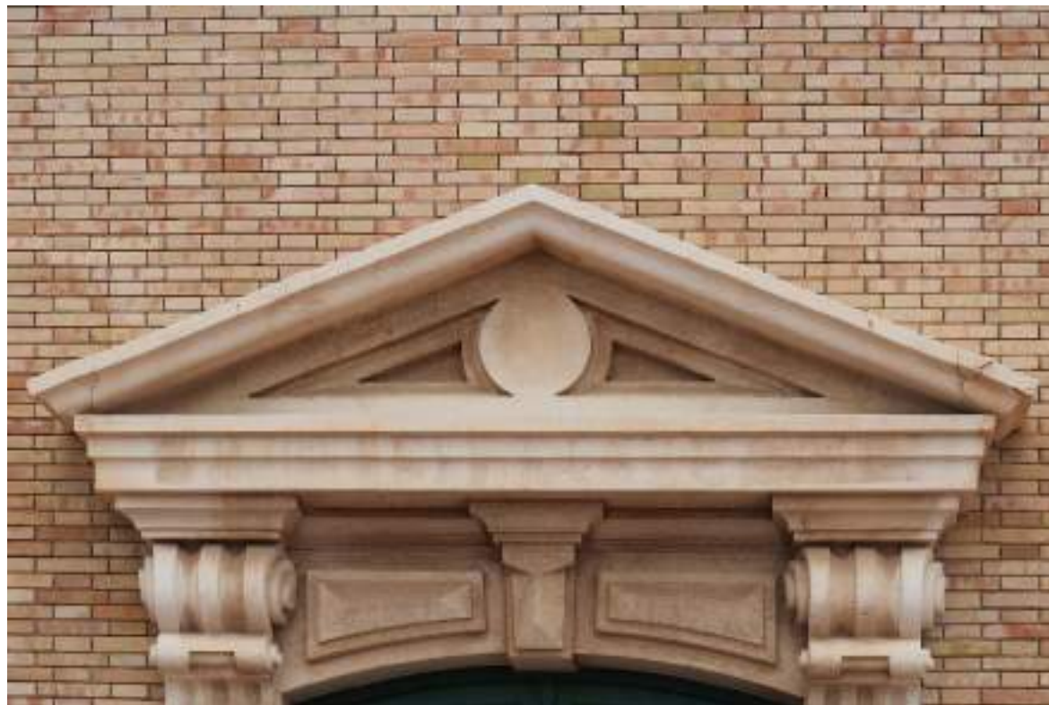
Depósitos de suciedad superficial en las ventanas de la primera planta. Se aprecian como zonas más claras o limpias aquellas más expuestas al lavado del agua de lluvia y a la acción del viento.
