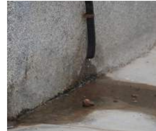
▼ Detalle de la salida de agua de un tubo de forma directa sobre la piedra de granito, manchando y humectando continuamente una zona localizada del zócalo
