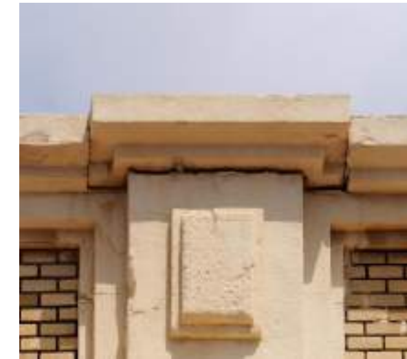
▲ Separación de piezas de pieza artificial por fallos en los anclajes. En la imagen se aprecia como en este caso se ha acuñado usando un palo.
