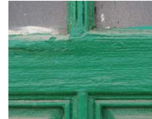
▼ Detalle de una carpintería donde por el aspecto de la madera podría haber sufrido ataque de hongos.
