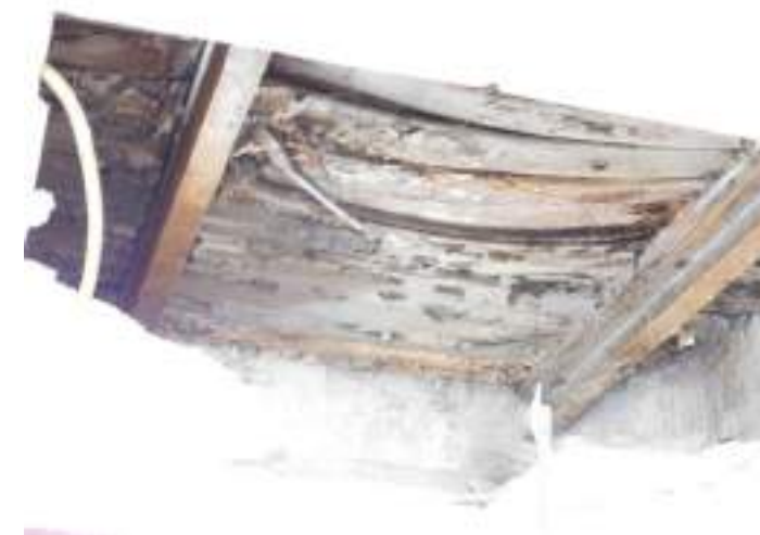
Pudrición del entrenervado de madera del forjado.
