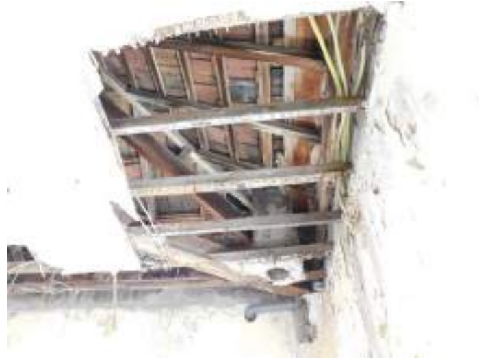
Pudrición y desprendimiento de falso techo. Presencia de manchas de humedad y levantamiento de pintura en paramentos.
