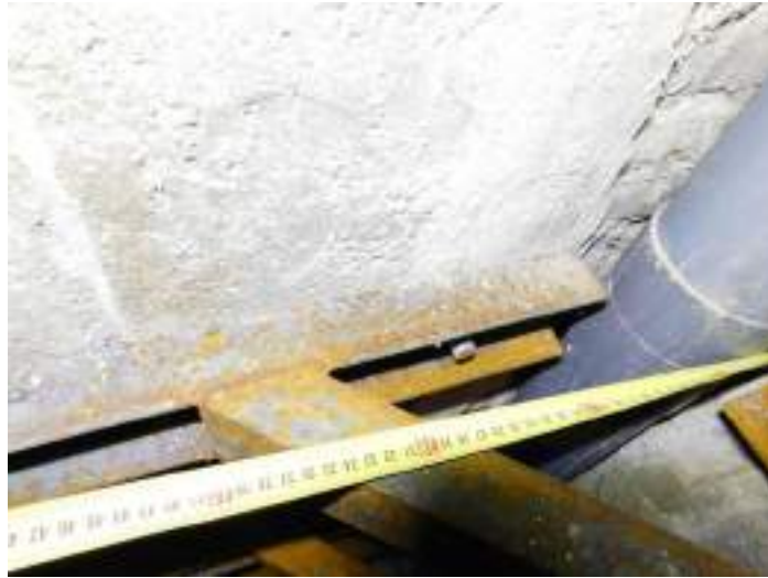
Muestras de corrosión en los refuerzos en esquina de la cubierta. Vista en detalle.
