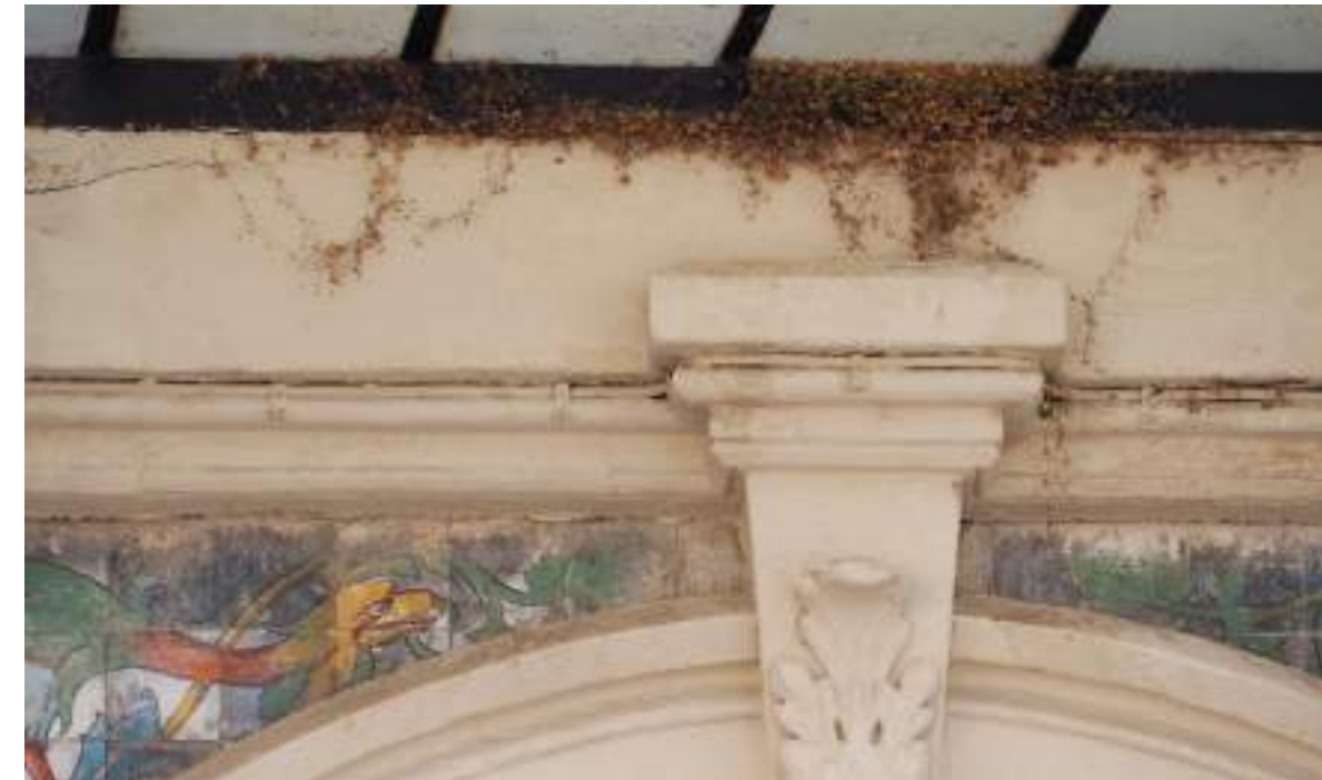
Desarrollo de vegetación en la piedra caliza bajo la marquesina, favorecido por los depósitos de suciedad superficial y la condensación y filtración de agua en el encuentro entre los elementos.
