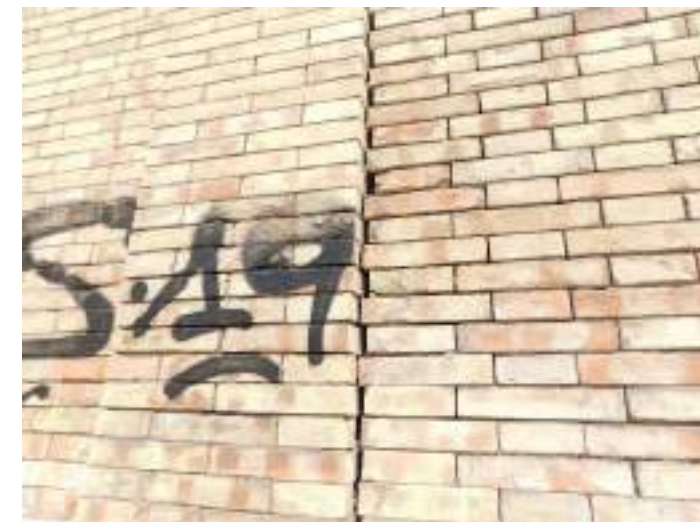
Grieta vertical en pilastra de fachada sur. Vista en detalle.
