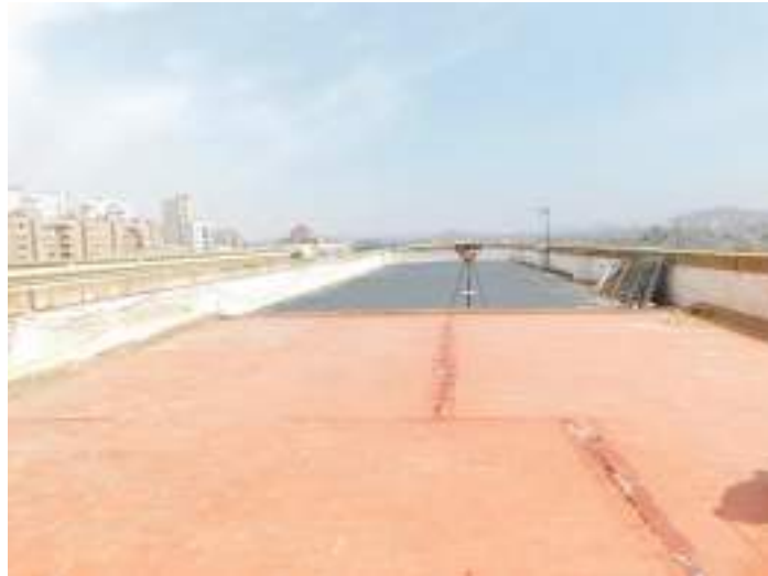
Zona de terraza con fractura y levantado de piezas cerámicas.
