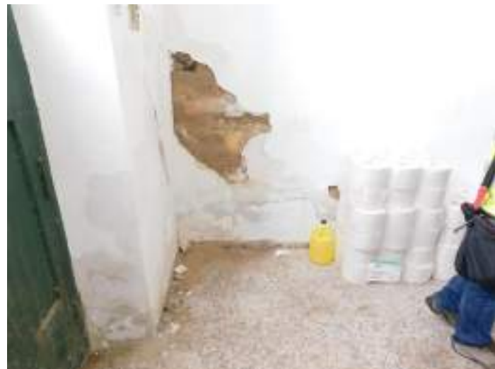
Humedades y desprendimiento del muro.
