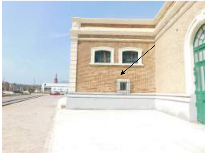
Grieta vertical bajo huecos en fachada este. Vista general.
