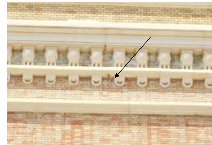
Grieta en esquina superior de la fachada este. Nave central. Vista en detalle.
