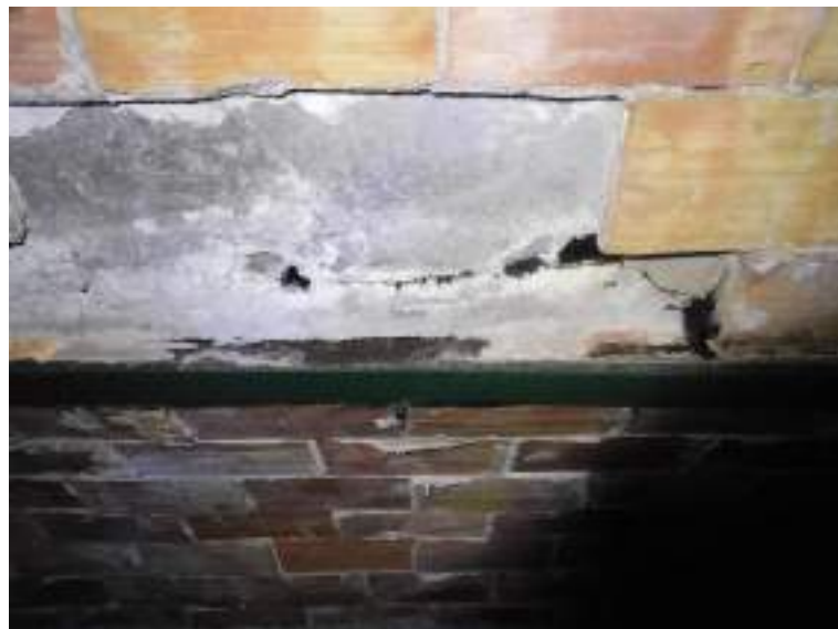
Oxidación de vigueta en cubierta central.
