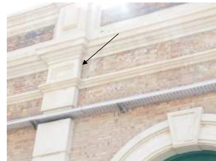
Grieta vertical junto a pilastra. Edificio de trabajadores.
