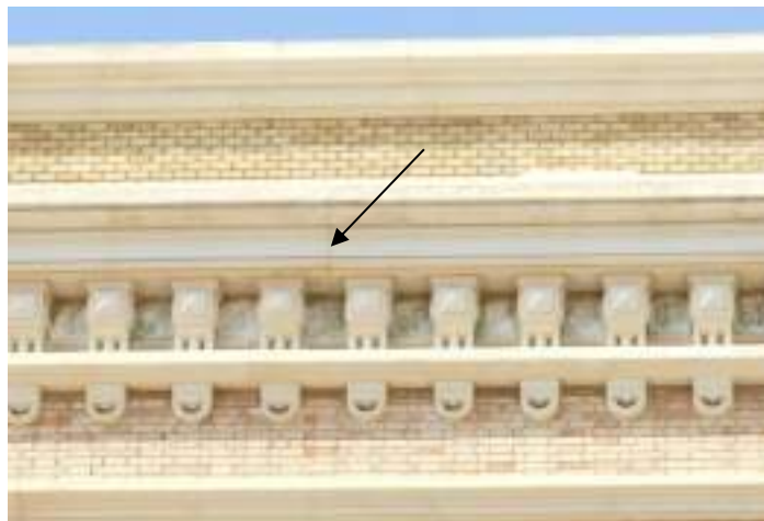
Grieta en esquina superior de la fachada este. Nave central. Vista en detalle.
