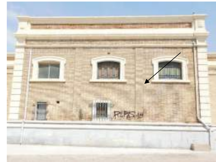
Grieta vertical en pilastra de fachada sur. Vista general.
