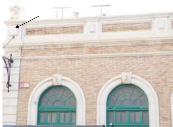
Muro oeste. Grieta vertical junto a esquina norte.
