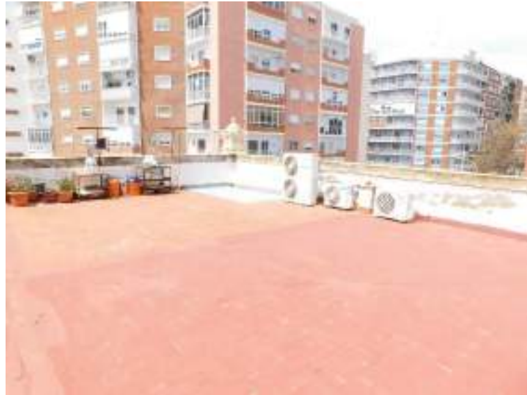
Vista general de la cubierta de la nave norte. Terraza en esquina noroeste.
