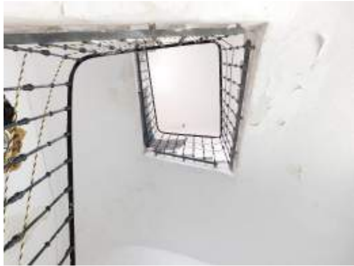
Humedades en tramo de escalera de la nave norte. Vista inferior.
