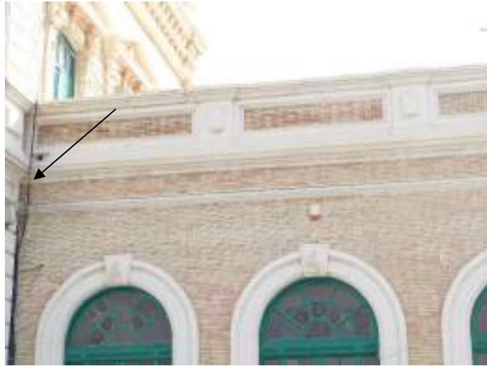
Grieta en fachada oeste de la nave lateral sur. Encuentro con nave central.
