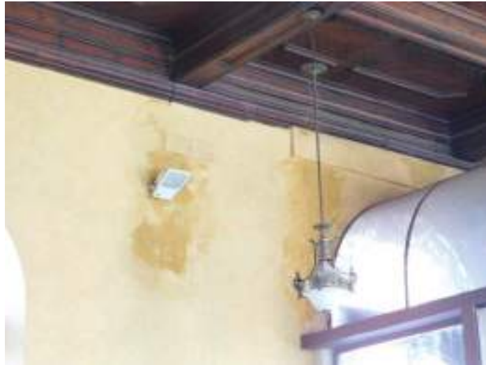
Zonas con humedades sobre las puertas de acceso.
