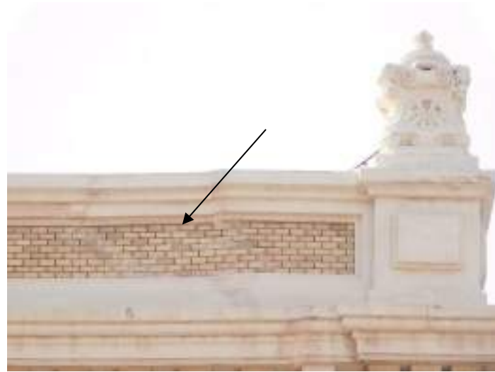
Grietas oblicuas en las esquinas de la fachada norte. Nave norte. Vista en detalle.
