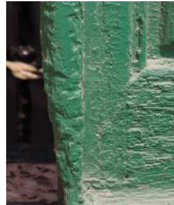
◀ Detalle de una carpintería donde se hace evidente la pudrición fibrosa de la madera bajo el repinte verde.
