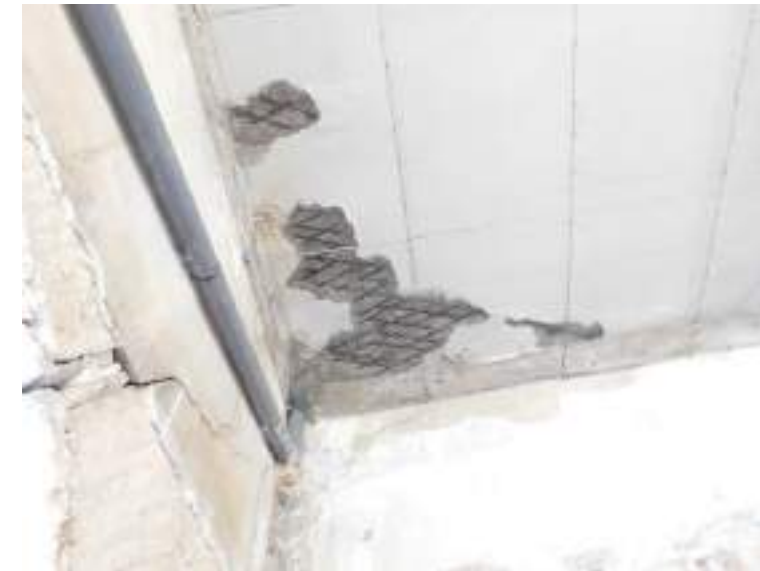
Desconchones en cara inferior de cubierta noroeste.
