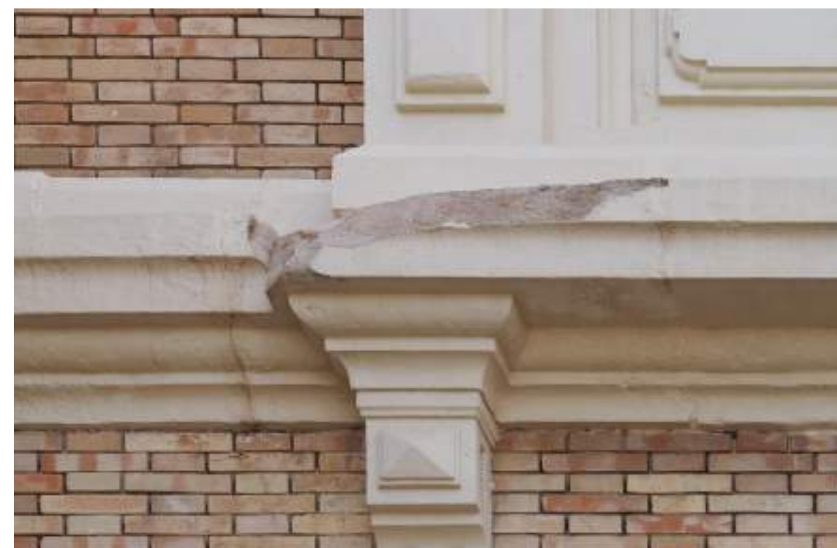
Desprendimiento de un fragmento de piedra caliza de importante tamaño en la parte inferior del primer vano abierto en la primera planta en la fachada trasera. La falta de suciedad en la fractura nos hace suponer que pueda haberse desprendido recientemente, después de la intervención de 2018.
