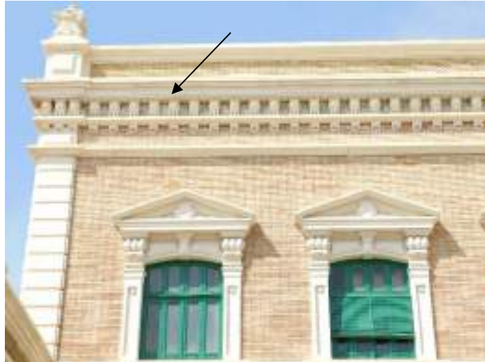
Grieta en esquina superior de la fachada este. Nave central. Vista general.
