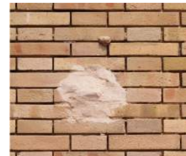
▼ Detalle de un parcheado de cemento en la fábrica de ladrillo, realizado de forma descuidada.
